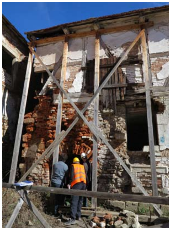
Havarijní stav nároží vozových kolen, březen 2014 (foto Jan Trnka)
